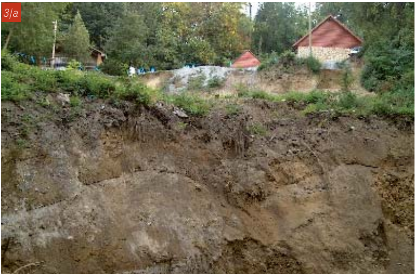
3 a, b. kép: A rézsű feletti vízelvezető csőből kiszivárgó víz következtében a partoldal lecsúszott
