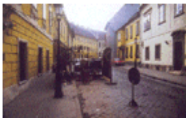
4. kép. A Táncsics Mihály utcai akna látképe a megerősítési munkálatok kezdetén
