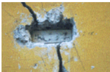
5. kép. A megsüllyedt épület repedésének tágulás-mérése
